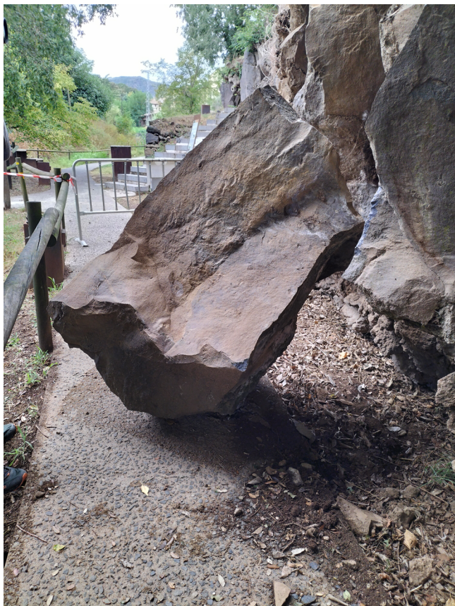
Figura 4. Despreniment_Santa_Pau: Bloc de basalt després a causa de les onades de calor del 2023.
